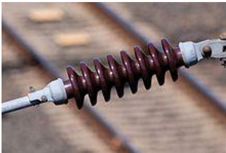
Isolateur céramique utilisé pour supporter les câbles haute tension
