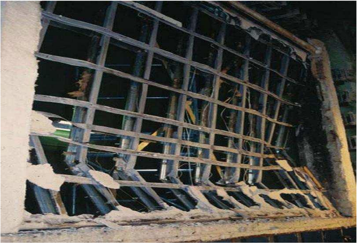
(Exemple d'un mur porteur à poteaux d'aciers après un essai de résistance au feu)
