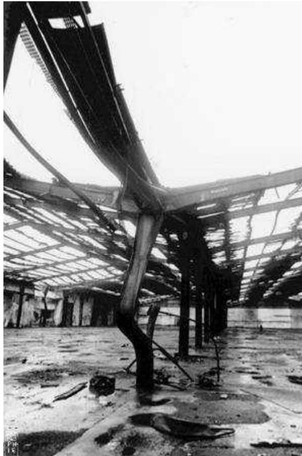
Structure métallique ayant plié sous son propre poids.
